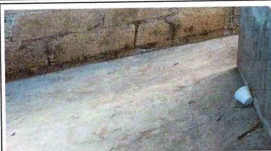
FOTO 7: Sustrucción de piso de torta de concreto EN COCINA
